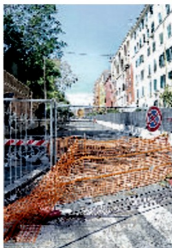
Via dei Marruccini, chiusa in parte per il crollo di un tratto di muro di cinta di Villa Mercedes
